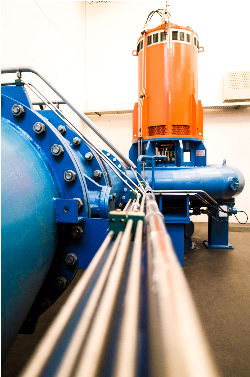
Kleinwasserkraftwerk (KWKW) Trümpler (Bild: Energie Uster AG).
