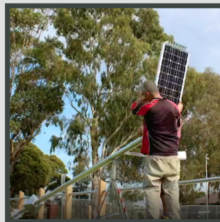
2. Pole & solar light
