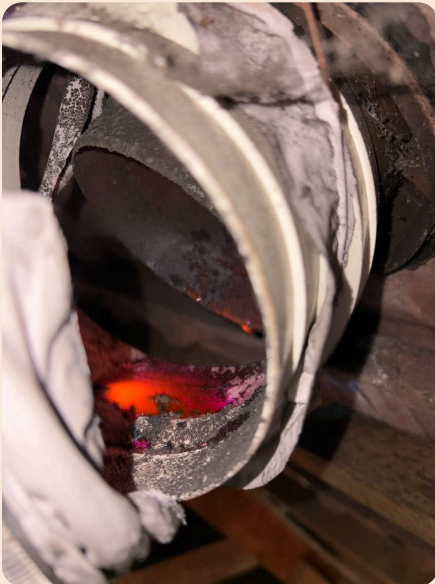
Présence de fluorescéine UV dans le comble
