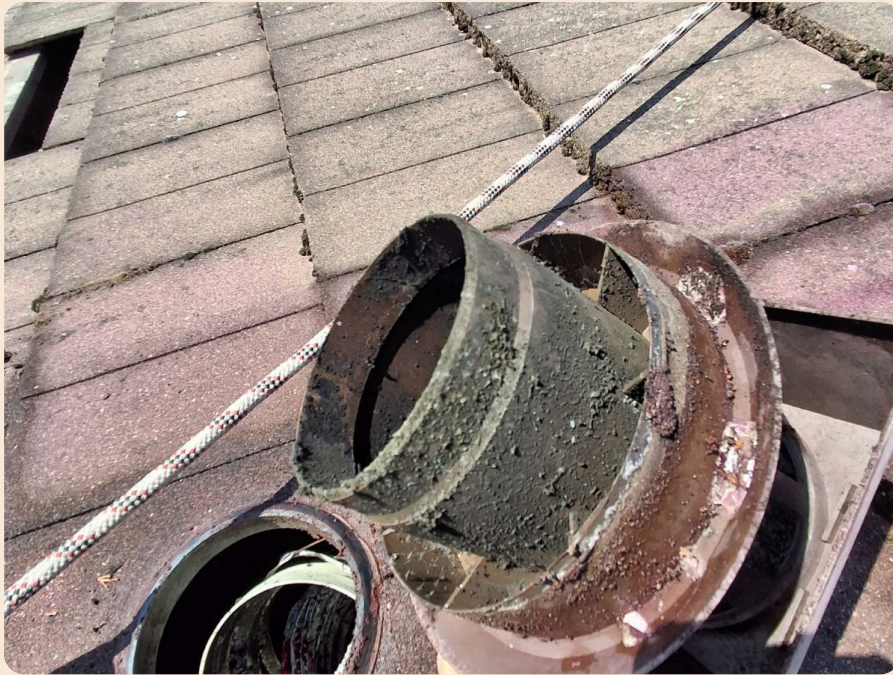
Absence de joint d'étanchéité
