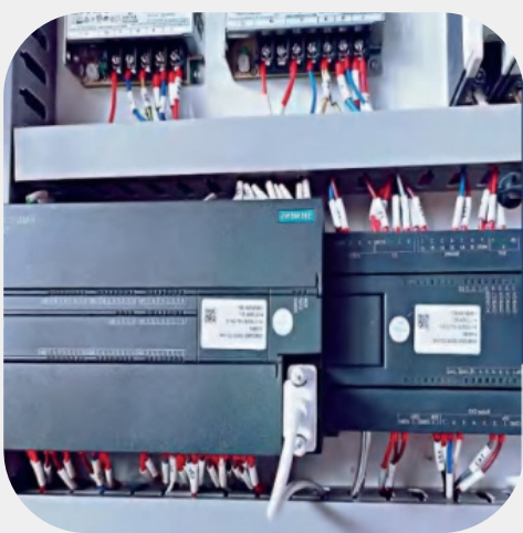
Controlador programable PLC con control totalmente automático SIEMENS®.
