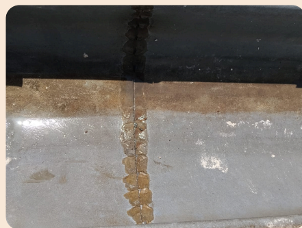
Autre soudure fuyarde dans le chéneau
