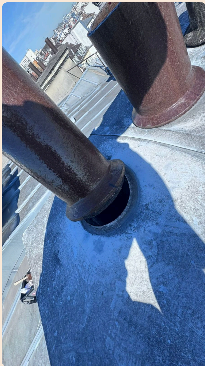
Mitrons non scellés risque de chute
