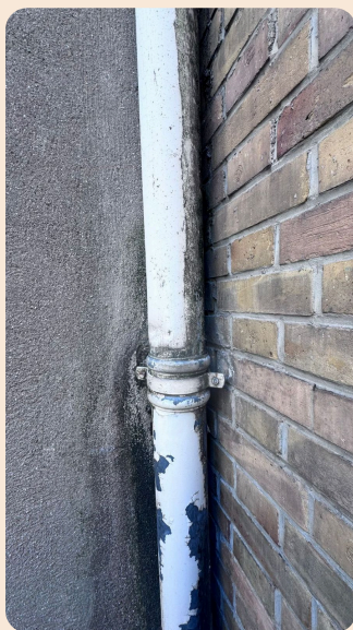
zone fuite descente
