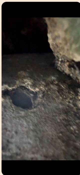
descente trouée à l'arrière de la descente
