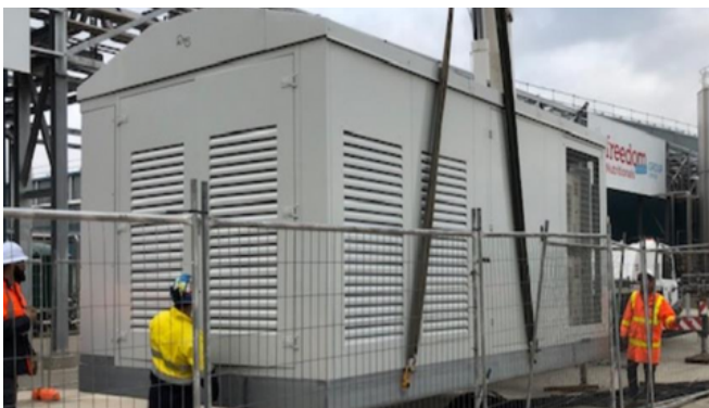
Solar HV Skid One - 1.1279MW
