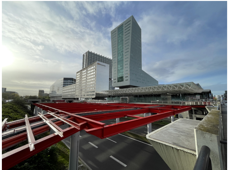
23 La dépose de l'ancien platelage, dégradé par l'action de champignons, révèle la structure de la passerelle désormais mise à nu.
