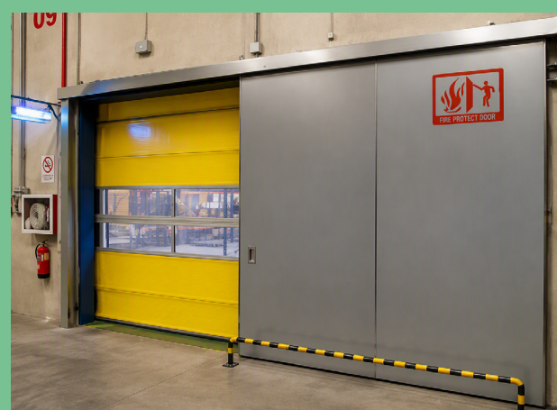
Figura: Puerta cortafuego equipada con un sistema de protección contra daños por impacto.
