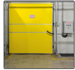
5 nolu Soğuk Hava Deposu
