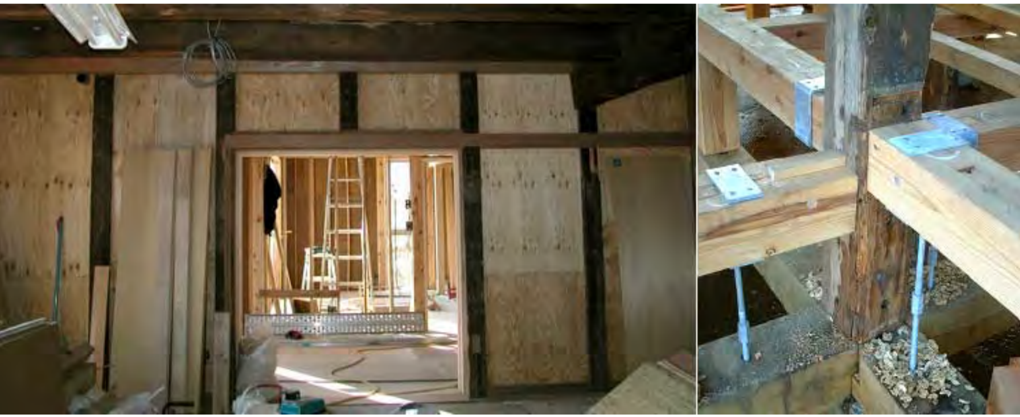
(左) 壁をかせぐために、土壁をおとして構造用合板を貼ったところ (右) 足固めをボルトで引っ張って補強。
