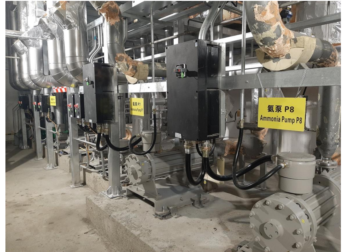
Maschinenhalle mit NH 3 Pumpen
