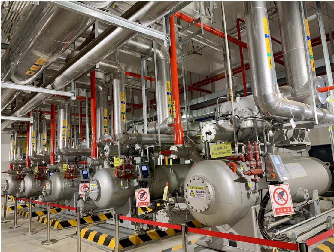
Maschinenhalle mit Schraubenverdichter - Sätzen
