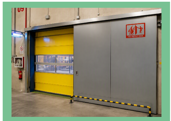
Abbildung: Brandschutztür mit Schutzvorrichtung gegen Anfahrsschäden.
