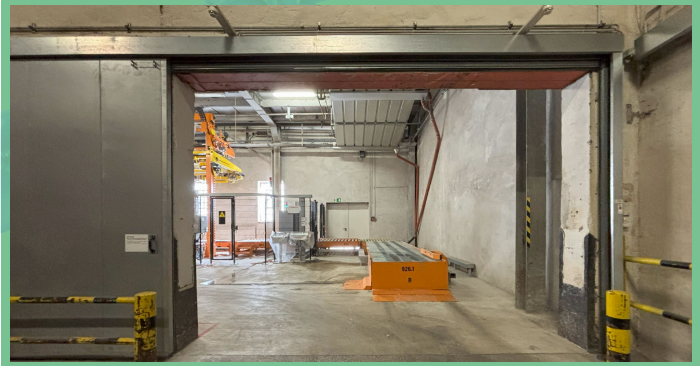
Abbildung: Brandschutztür mit Schutzvorrichtung gegen Anfahrsschäden.
