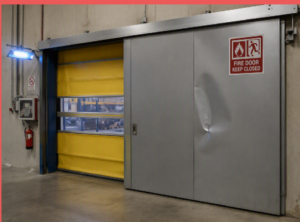
Abbildung: Beschädigungen beeinträchtigen die zuverlässige Schließfunktion. Brandschutztüren sollten Schutzvorrichtung gegen Anfahrsschäden aufweisen.
