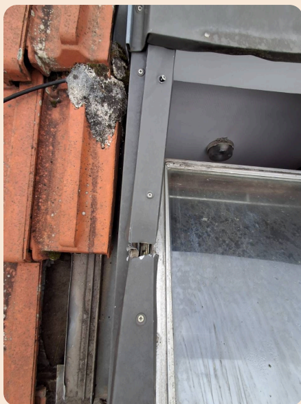
Présence de mortier au niveau du raccord d'étanchéité avec la toiture
