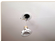
Foco suelto, cables expuestos
