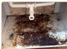
Mueble del fregadero oxidado
