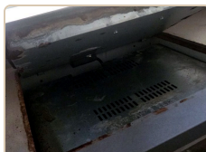
Óxido en hueco de parrilla
