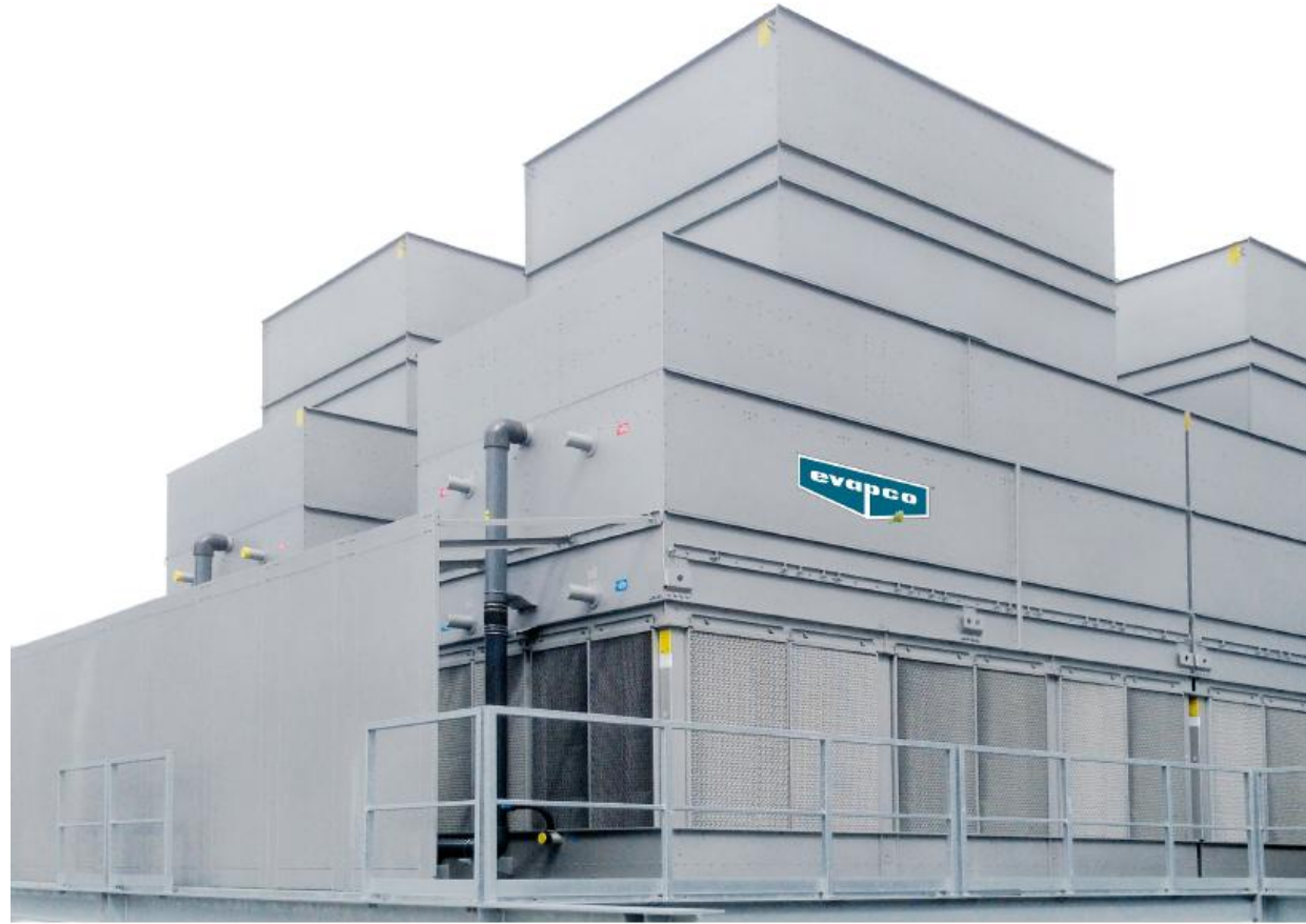
Aggregat mit Schallschutzwänden vor den Luftansaugittern und Abluft-Schalldämpfer
