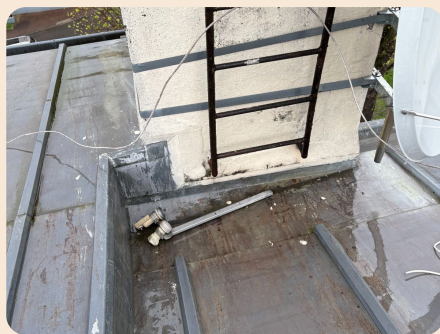
Débris en toiture
