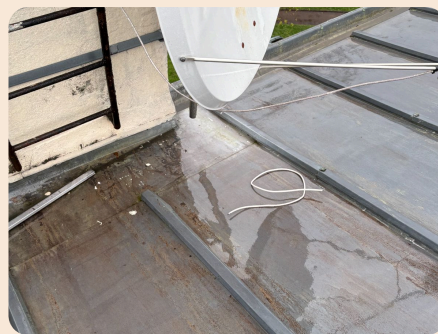
Débris en toiture
