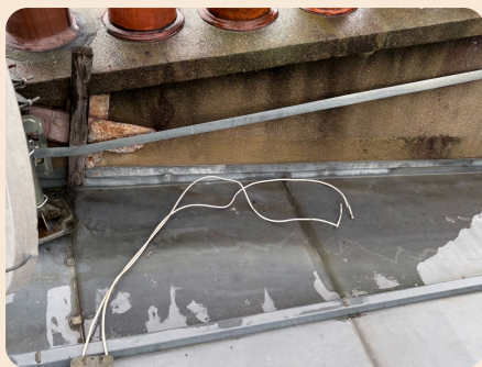
Débris en toiture
