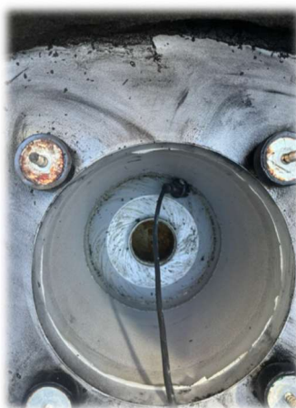
Enhet där motor och rotorstack är demonterad för rengöring
