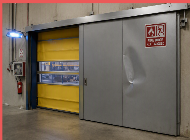
Figura: Los daños pueden afectar el correcto y fiable funcionamiento de cierre. Las puertas cortafuego deberían estar equipadas con dispositivos de protección contra impactos de montacargas u otros vehículos industriales.
