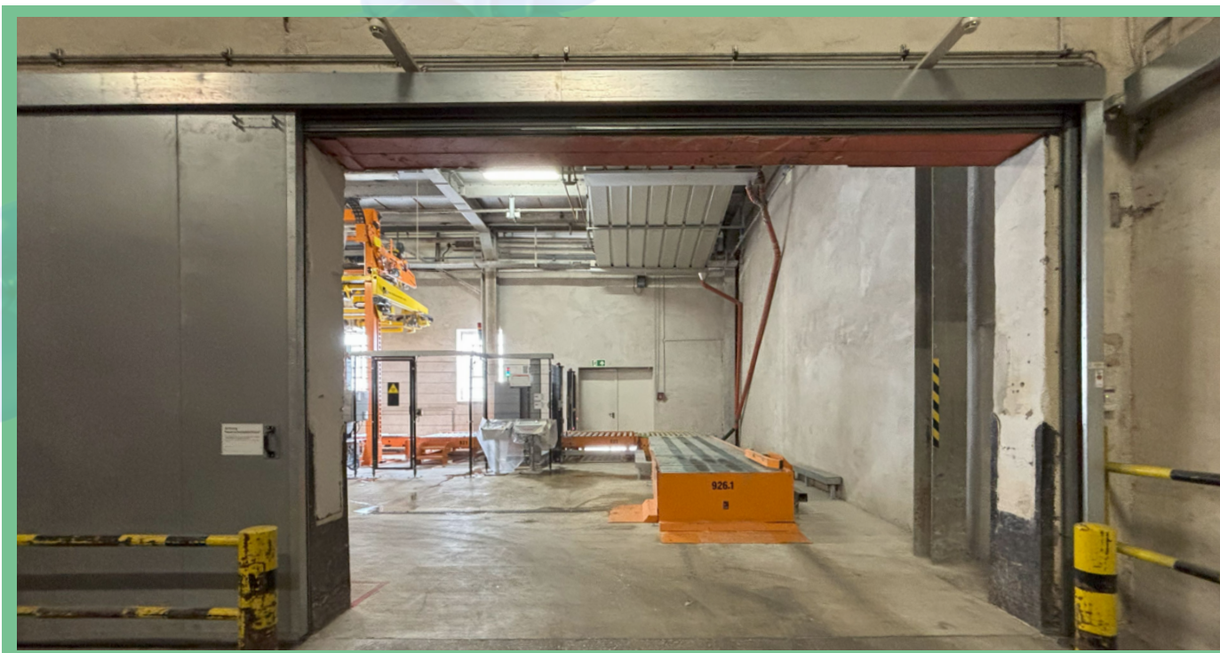
Figura: Puerta cortafuego con protección contra daños por impacto.
