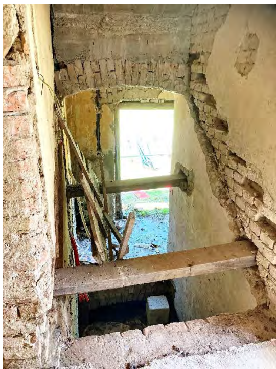
Sl. 54. Porušeni stubišni krak između prizemlja i potkrovlja, P5
