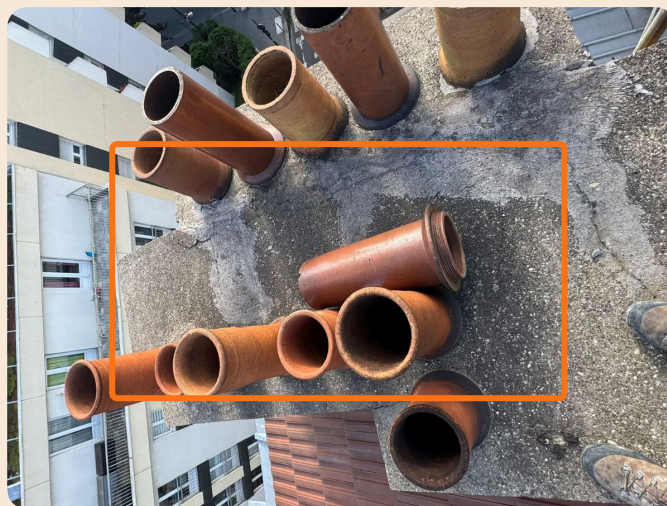
risque de chute imminente: élément mis en sécurité
