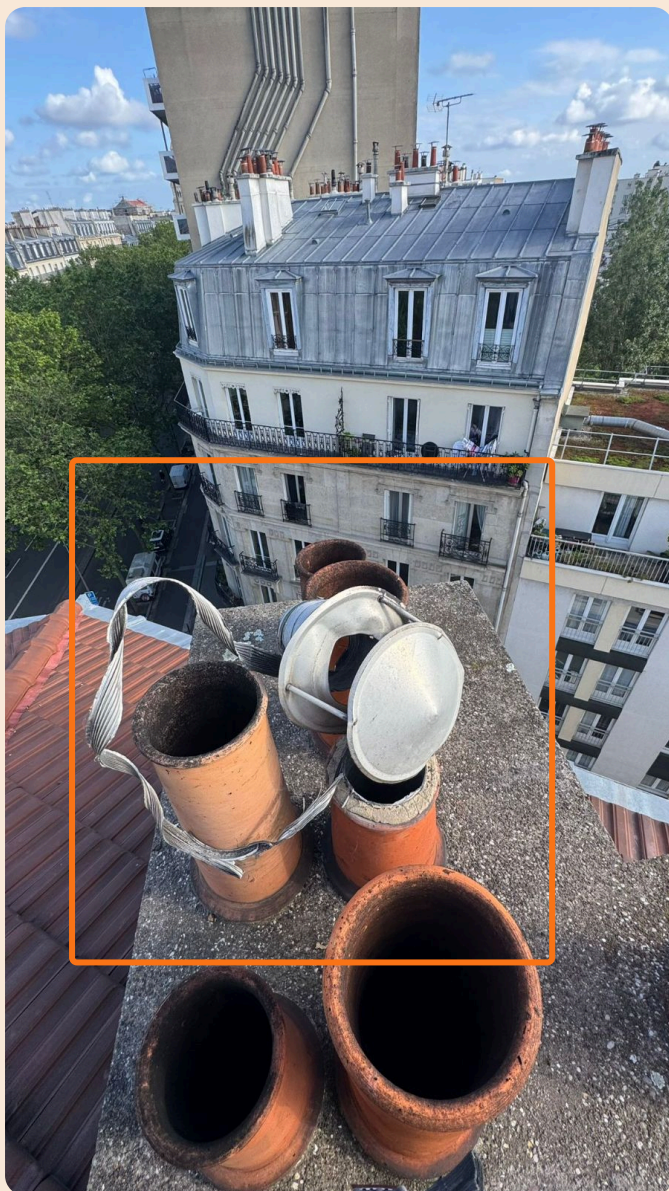
risque de chute imminente: élément mis en sécurité
