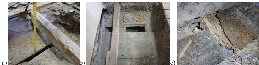
Slika 7. Istražne kaverne: a) drvena tavanica iznad prizemlja, b) čelični nosač u polovini raspona tipске tavanice iznad prizemlja, c) drveni nosač tavanice iznad sprata
