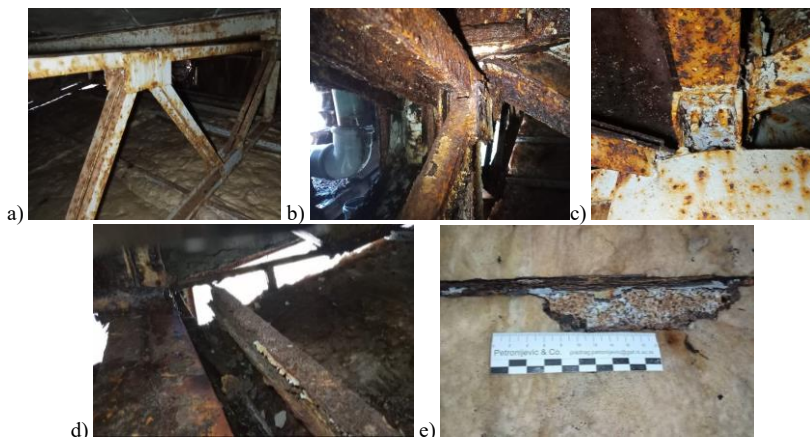
Slika 6. Stanje čelične krovne konstrukcije: a) čelični rešetkasti nosač, b) čelična konstrukcija u delu fasade, c) veza čelične konstrukcije, d) plafonska potkonstrukcija, e) rukom uklonjen deo konstrukcije
