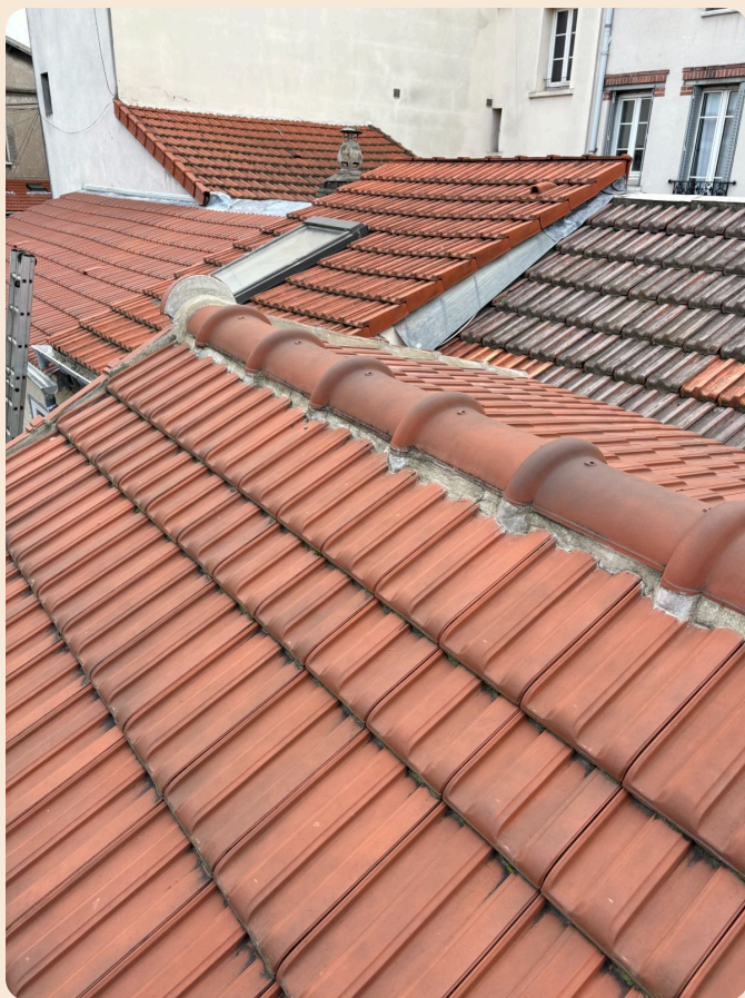
Avant - fissures nettes
