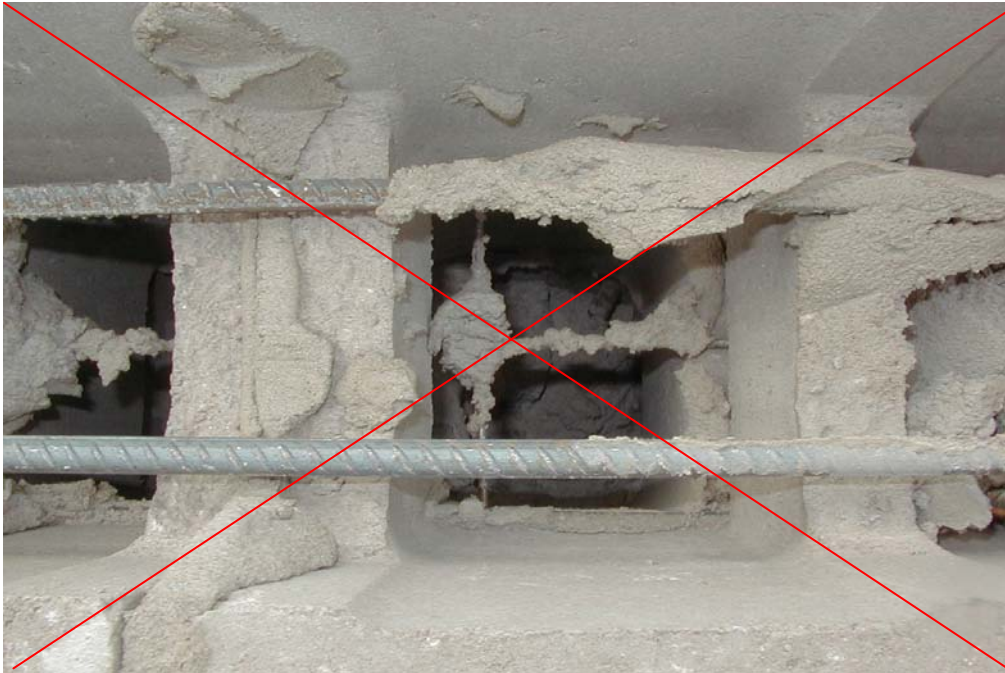
Foto 3 Lubamatult laotud müür (mört on varisenud betoneeritavasse allasse)
