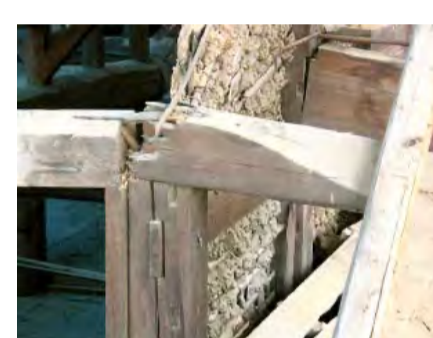
瓦の重みで破風を支える母屋が折れている。
