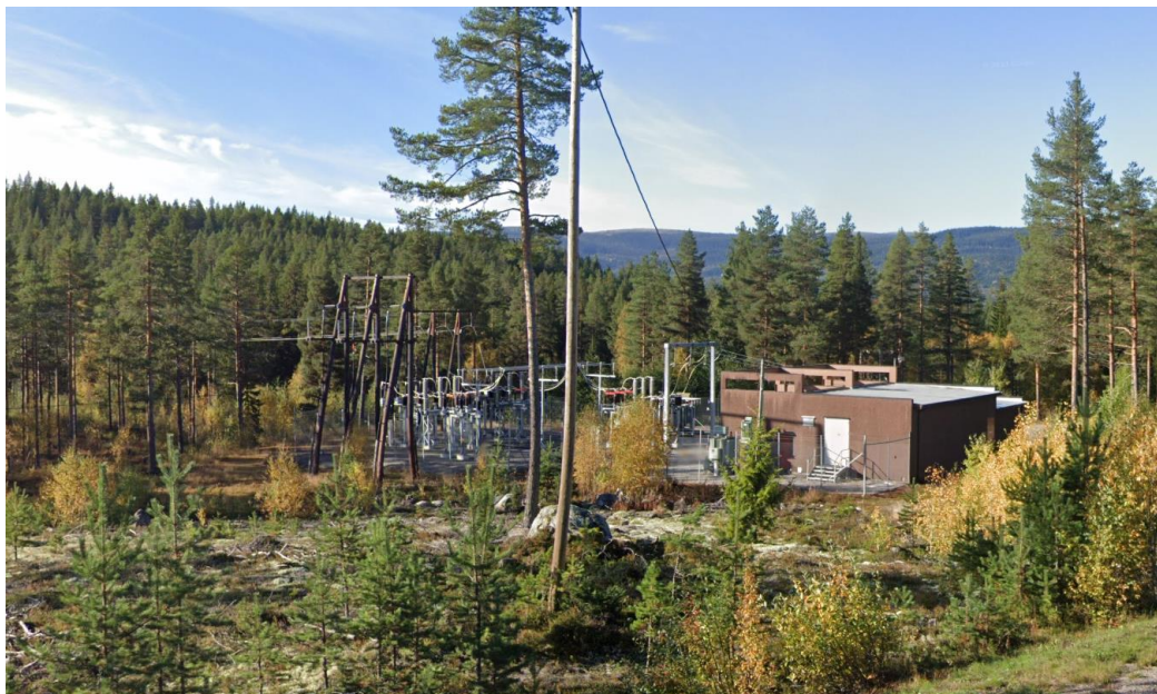
Figur 9 Koppang transformatorstasjon (Kilde: Aneo AS)
