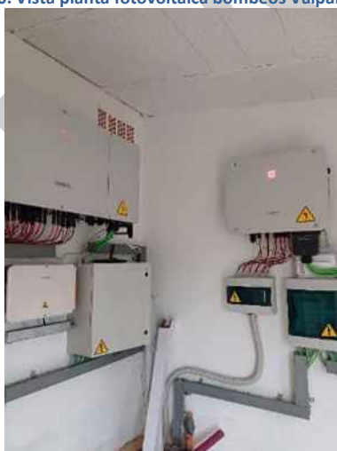
Ilustración 22. Equipamiento Planta fotovoltaica en Bombeos Valparaíso
