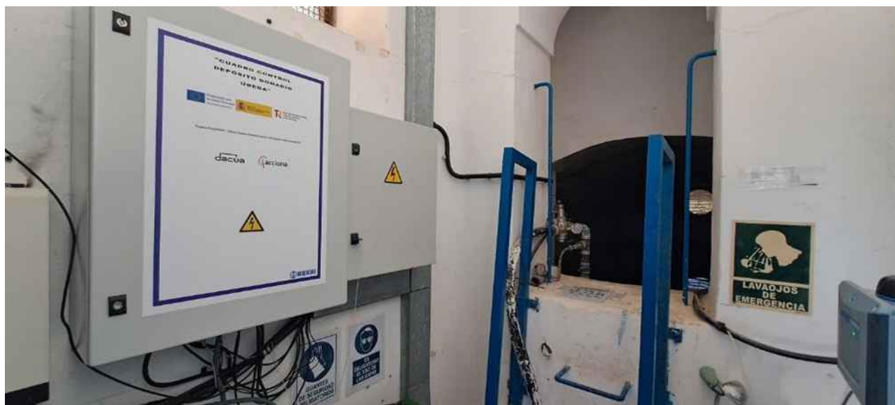
Ilustración 47. Sensórica y cuadros de control Depósito de Donadío
