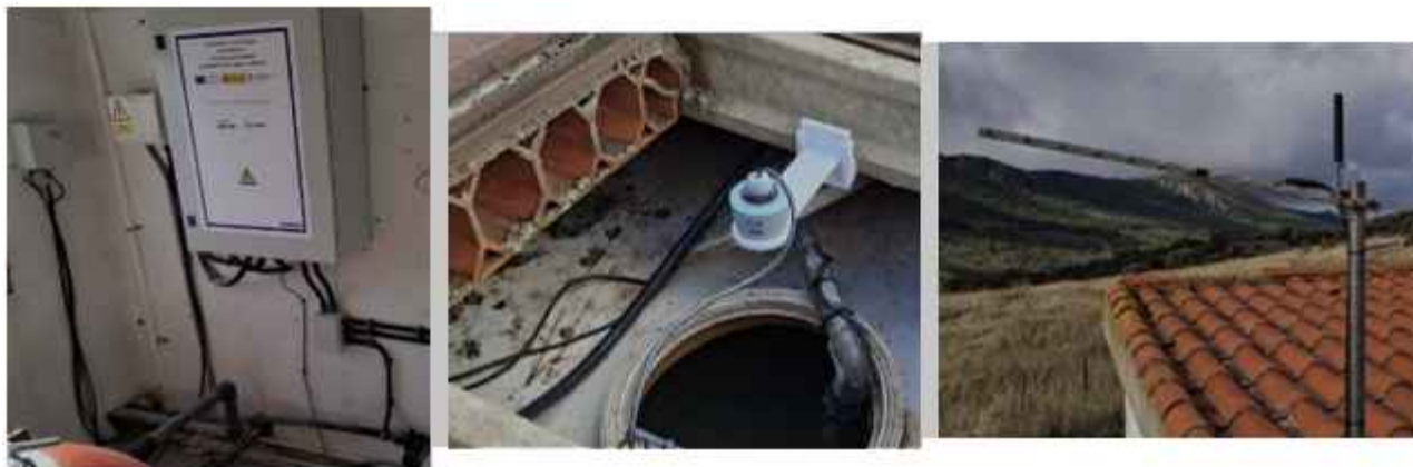
Ilustración 117. Equipos instalados depósito Valdeazogues
