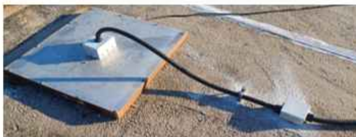
Ilustración 119. Cuadro de Control y Conexión exterior del Depósito
