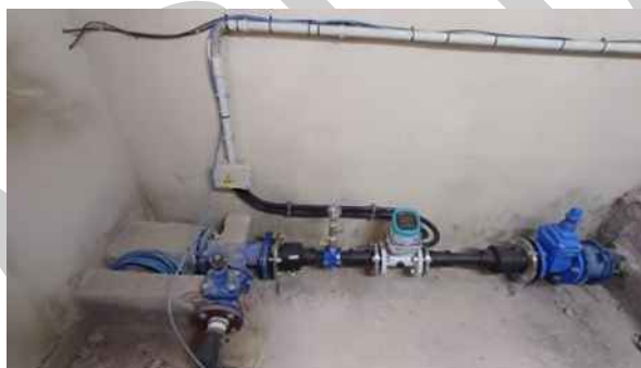
Ilustración 49. Caudalímetro Depósito Terrero Alto
