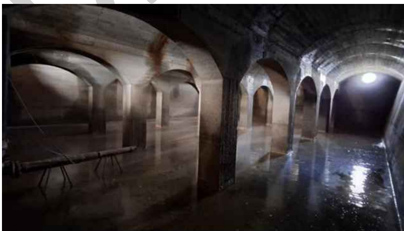
Ilustración 25. Imagen interior del Rebombeo
