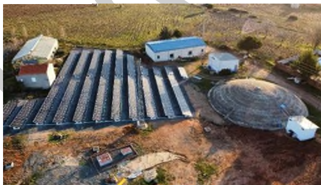
Ilustración 21. Vista planta fotovoltaica bombeos Valparaíso (II)
