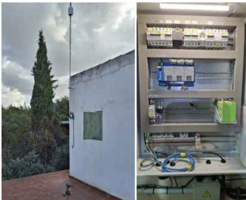
Ilustración 48. Imagen exterior y cuadro de interruptores del depósito Terrero Alto
