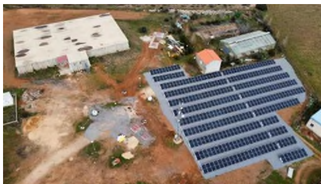
Ilustración 20. Vista planta fotovoltaica bombeos Valparaíso (I)
