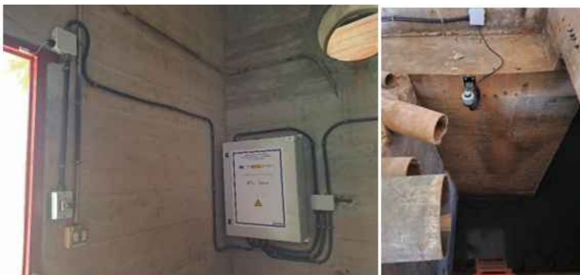
Ilustración 26. Remota y cuadro de control del rebombeo
