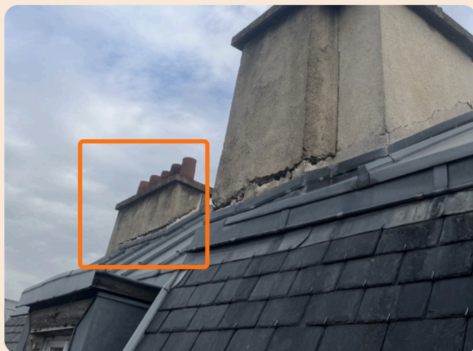
Cheminée 4 et cheminée 5 - avant reprise
