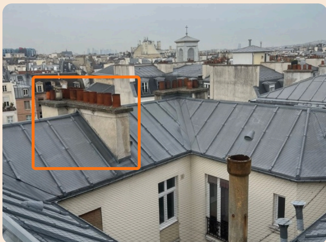
Cheminée 4 - avant reprise
