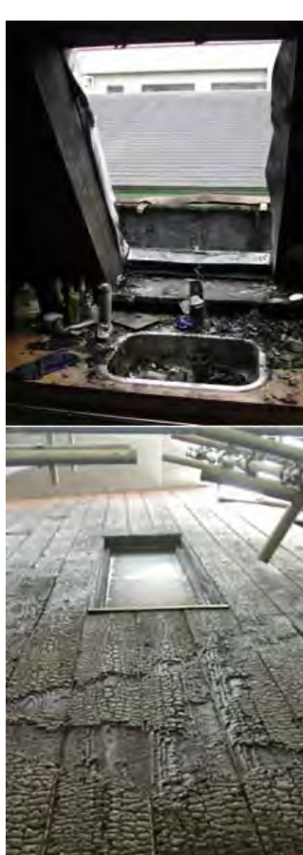
上：善養寺さんの火事現場。アルミサッシの枠は融けてしまった。下：杉板の外壁と木製サッシの枠は、炭化しながらがんばった。
