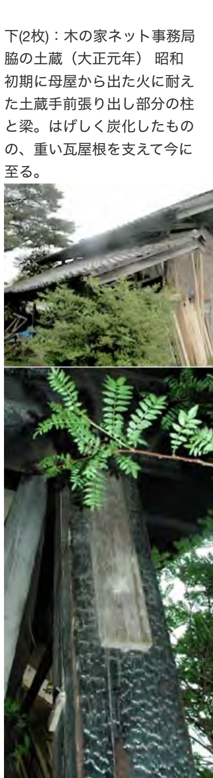
下(2枚)：木の家ネット事務局の土蔵 (大正元年) 昭和初期に母屋から出た火に耐えた土蔵手前張り出し部分の柱と梁。はげしく炭化したものの、重い瓦屋根を支えて今に至る。
