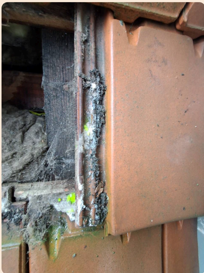
Encrassement des cannelures
