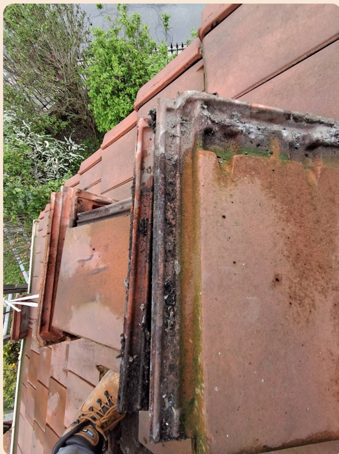
Encrassement des cannelures
